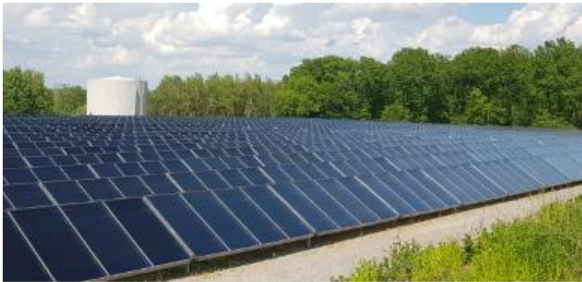
Exemple d'une installation de modules solaires au sol – Source : Gazonor
