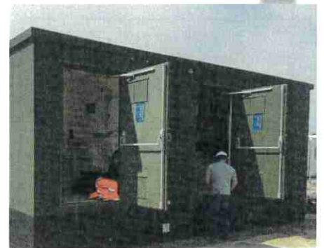
Photo de référence d'un poste de livraison et de transformation
